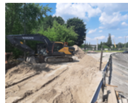
Trwa przebudowa odcinka drogi powiatowej w Pionkach wraz z budową mostu przy Stawie Górnym.
